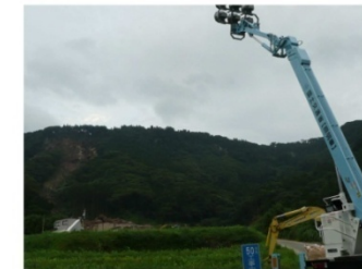
写真 4.3.18 夜間監視用の照明車
