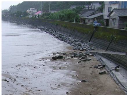
写真 2.1.4 高潮堤防の状況 (堤防高不足区間：第二有明橋右岸下流)
